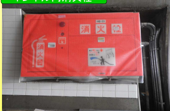
トンネル内消火栓
