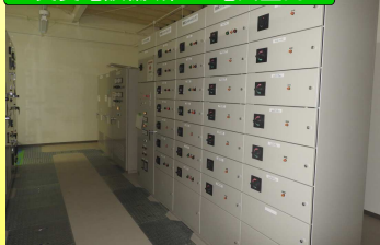
受変電設備(第12電気室内)
