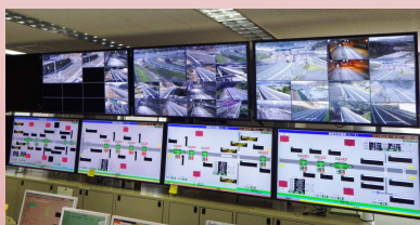
管理事務所内にある遠方監視制御とCCTVカメラのモニターです
