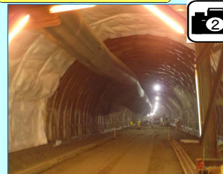
トンネル内の湧水を速やかに排水するため二次覆工前にシートで防水をします。
