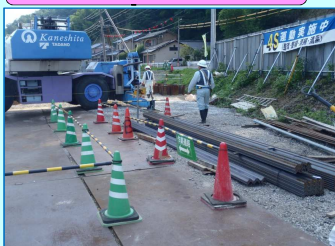
現場の整理整頓、安全通路の設置状況、熱中症対策などをチェックしました
